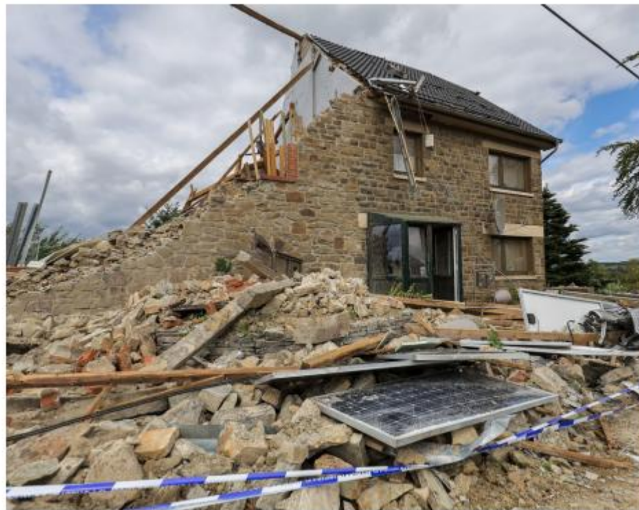
■ À Bullange, une possible tornade a lourdement endommagé une habitation. © BELGA
