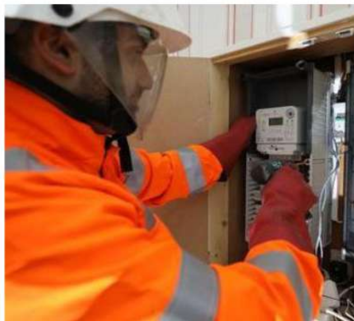
Resa a installé environ 120.000 compteurs communicants. © Resa
