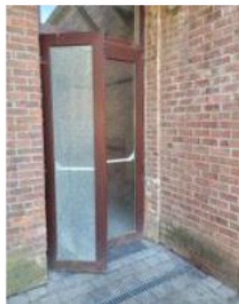
Les dégâts constatés. © DR
